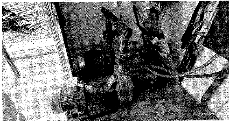
Imagen 8. Sistema de bombeo
