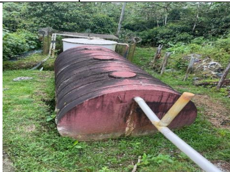
Tanques de almacenamiento de lixiviados
